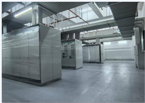
能源中心-水冷和暖通系统
