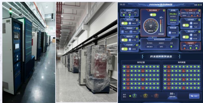
20套脉冲功率源已部署在速调管走廊，完成了加速管与速调管老炼测试（20只80MW 速调管和20套固态调制器）
