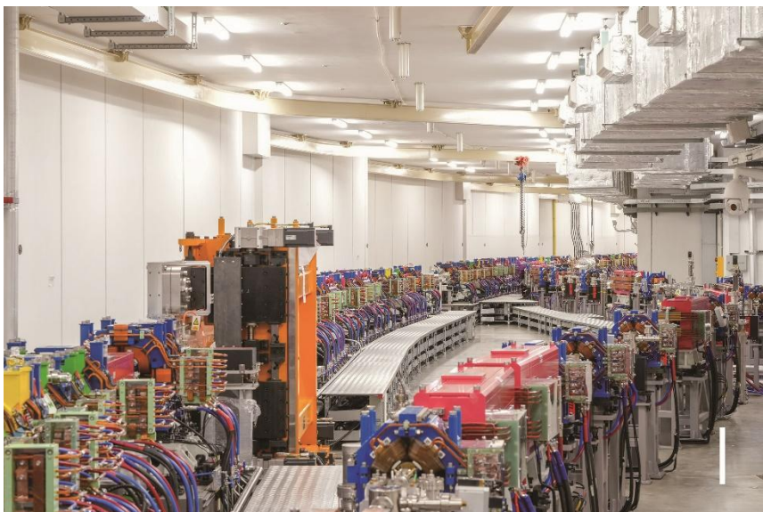
储存环 运行中
